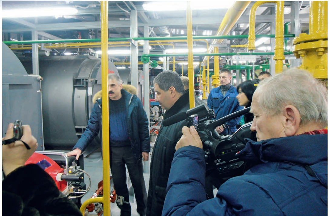
Запуск газовой котельной
